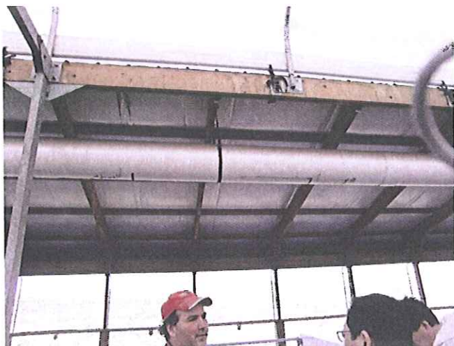
写真3 上部陽圧換気用のパイプ
