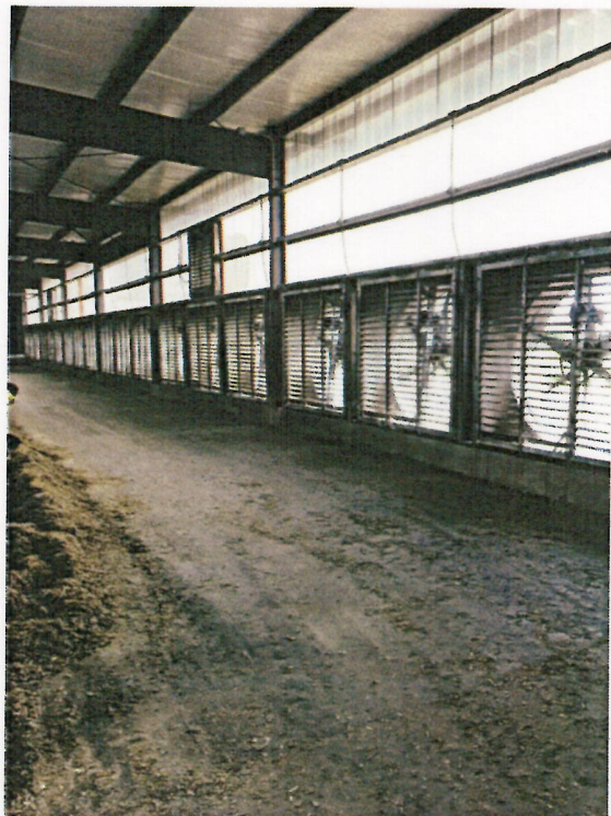
【排気ファン…内部】
