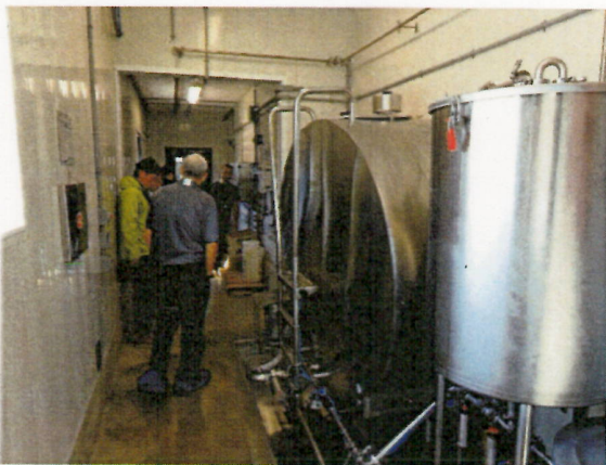
【処理室…手前の小さいのがバッファタンク】
