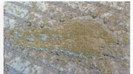
泥状で辺縁が不整 飛び散っている
