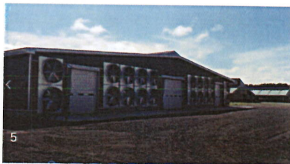
フリーストールのトンネル換気
