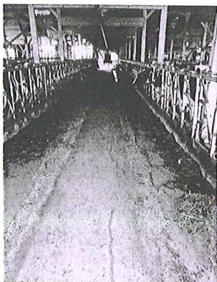
写真11 飼槽のコンクリート部分とレジン部分との境目辺りに白っぽく堆積した汚れ
