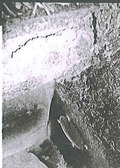
写真5 堆積し、今にも剥がれ落ちそうな汚れ
