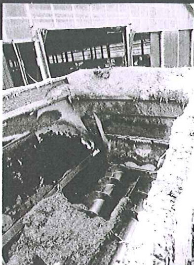
写真4 ミキサの上部辺縁に堆積した汚れ
