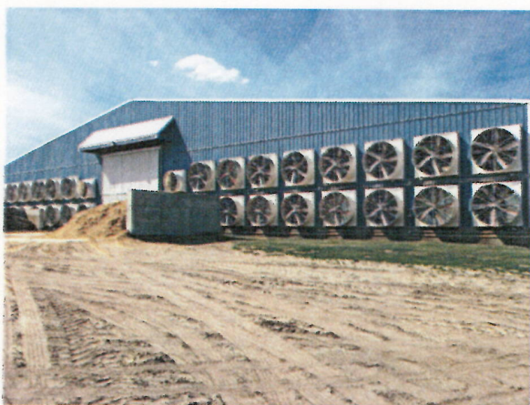
【800 頭牛舎の換気扇①…トンネル換気】
